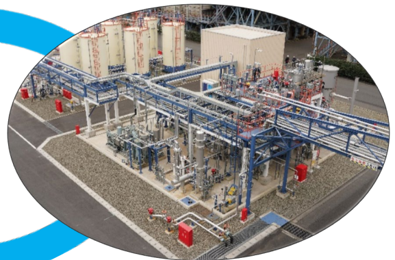
【脱水素プラント@川崎、日本】
